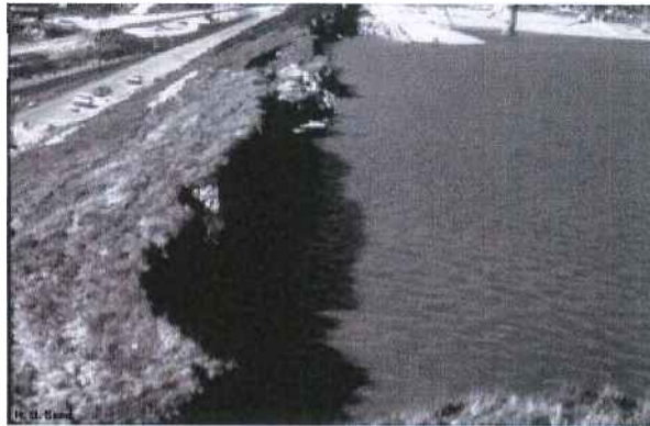
Figura 6. Deformación ocurrida en la represa de Lower San Fernando luego del sismo.
